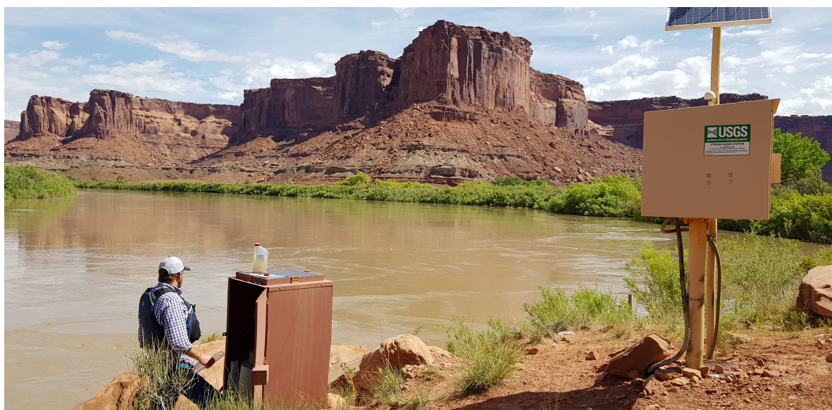
FIGURE 2.25. Station hydrosédimentaire typique avec armoire d'acquisition et préleveur automatique protégé dans une loquette, ici sur la Green River à Canyonlands en Utah.
