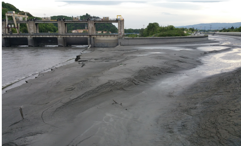
FIGURE 3.24. Dépôts amont au barrage de Beaumont-Monteux en 2015.
