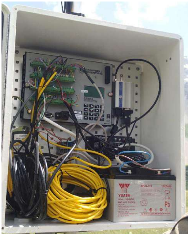
Intérieur du coffret de la CR3000
