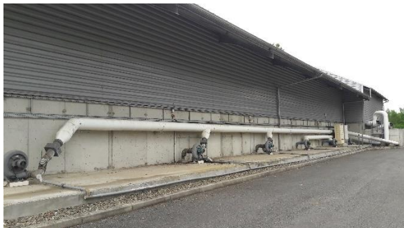
Figure 25 : ventilateurs (aération par aspiration) de la compostière
