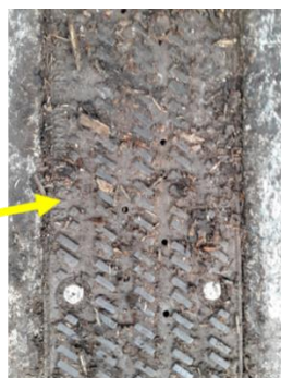
Grille protégeant la gaine d'aération
