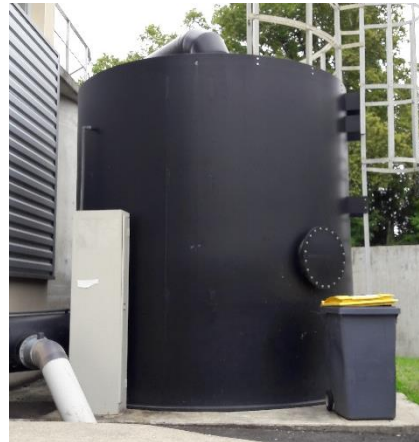
Figure 24 : Biofiltre ALIZAIR et procédé d'absorption (désodorisation bâtiments)
