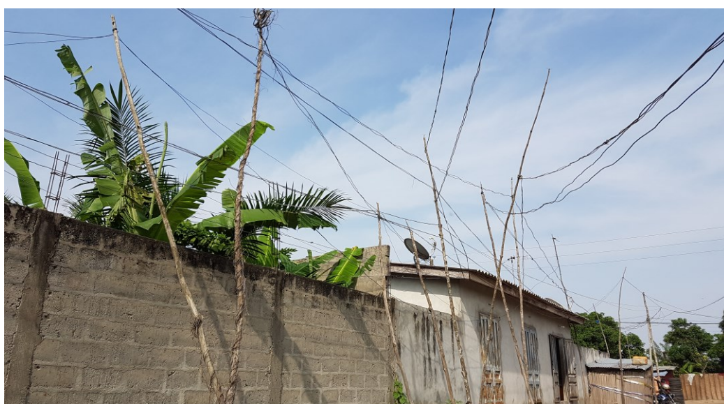
Photo 14 : Raccordement électrique illicite ou toiles d'araignées au Bénin
