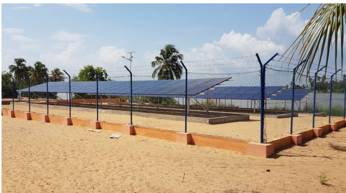
Photo 3 : La pico centrale solaire d'Avloh non encore mise en service
