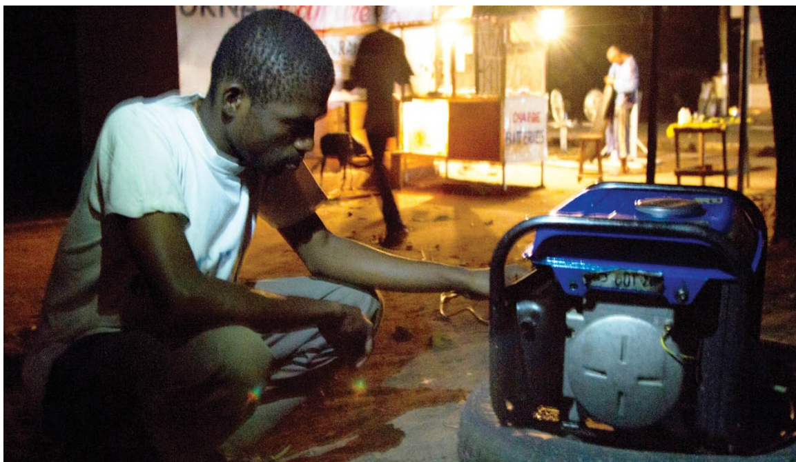
Photo 16 : Générateur électrique à essence (groupe électrogène) pour alimenter un petit commerce en énergie électrique
