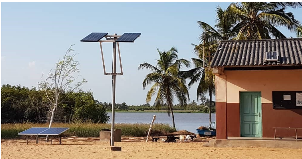
Photo 4 : Equipements solaires photovoltaïques du centre de santé d'Avloh
