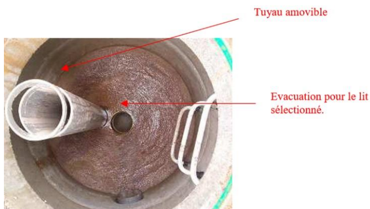
Figure 46. Regard de distribution effluent par tuyau amovible (Boutin et al , 2007).
