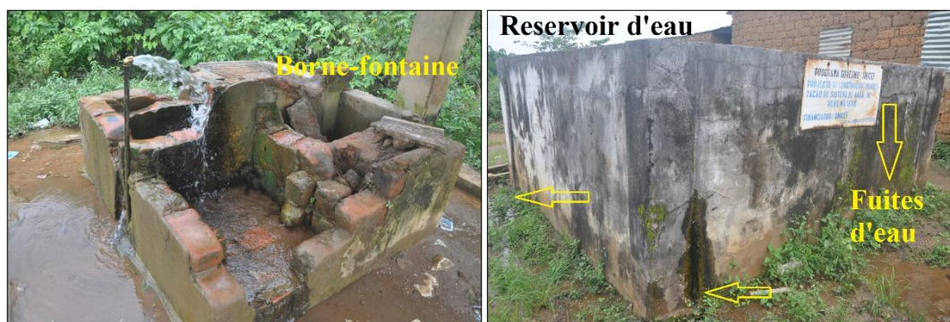
Figure 8. Robinets défectueux et dégradation du réservoir d'arrivée d'eau à Mateus, 2019.
