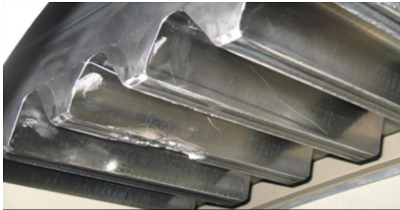
Figure 7 : Défaut de fissure [5]
