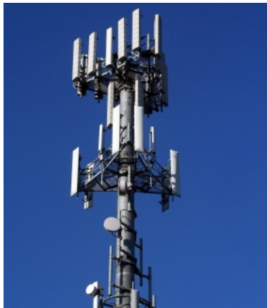
FIGURE 1.21 – Station relais de téléphonie mobile constituée de réseaux d'antennes linéaires d'une dizaine d'éléments.
