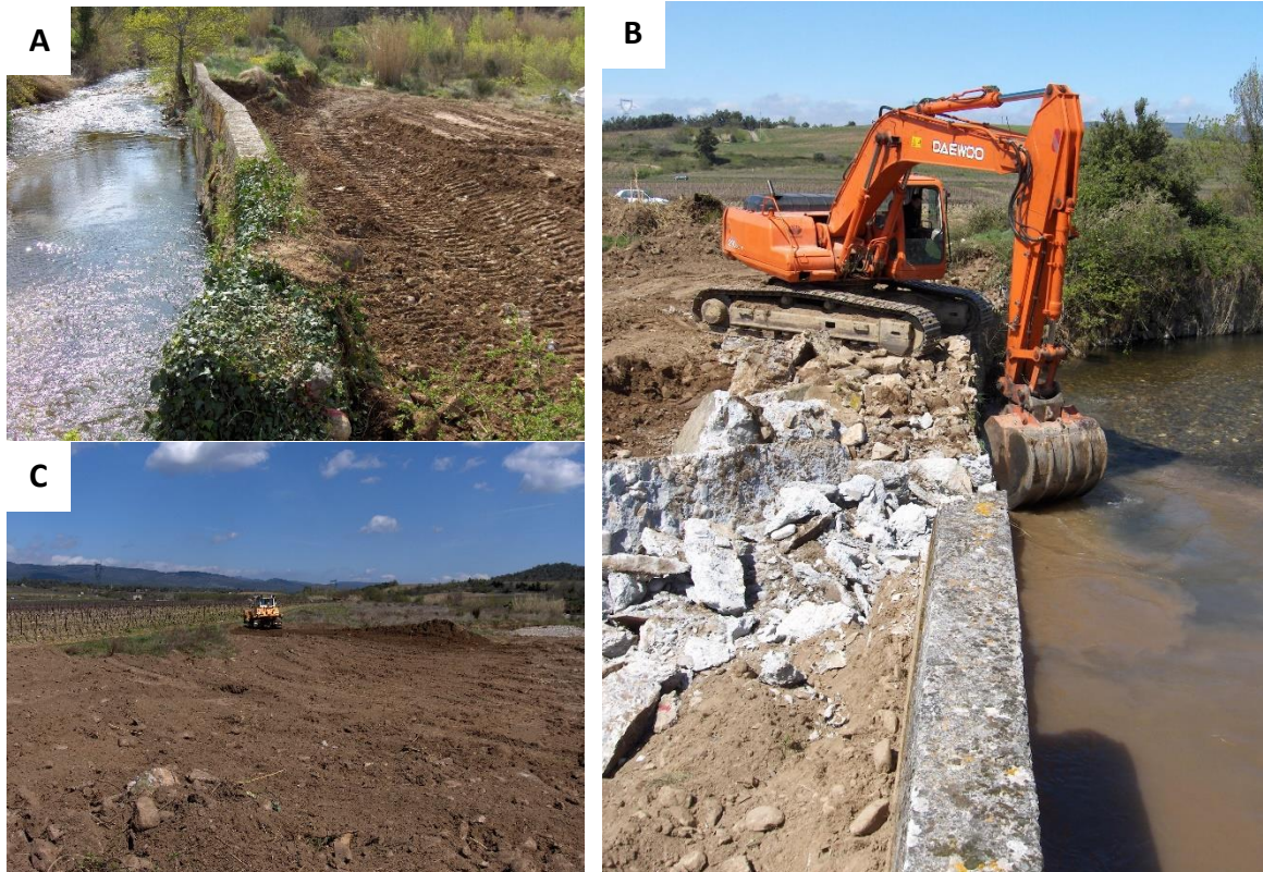
Figure 18 : Illustration des travaux de restauration dans le secteur aval de la Clamoux (photos : Syndicat Mixte Aude Centre, 2006)
