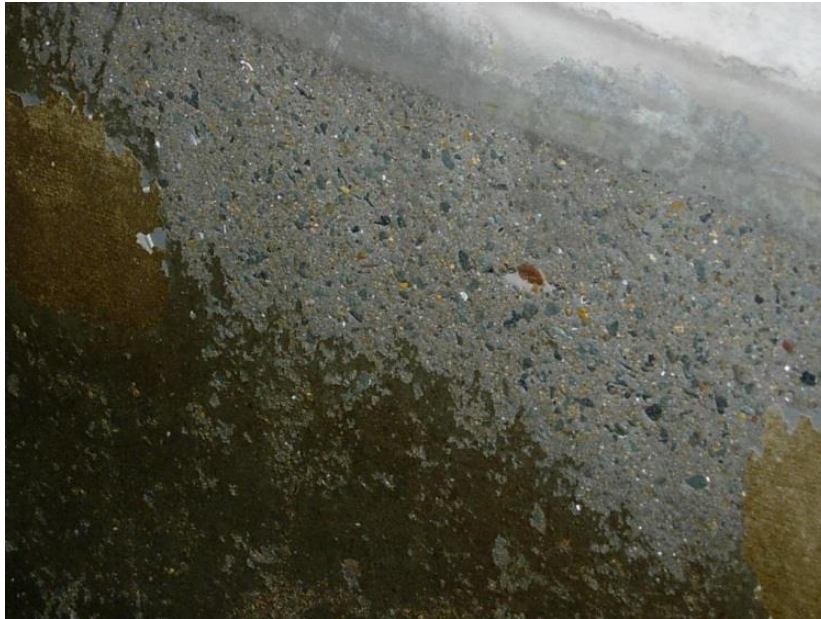
Figure 15. Photo de l'intérieur d'un ouvrage d'une station de traitement d'eau potable après 3 années de mise en service.
