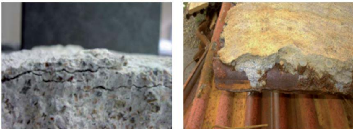
Figure I.4-5 Endommagement et fissuration d'un garnissage réfractaire non façonné (béton) utilisé dans un incinérateur. [SCHNABEL, 2005]
