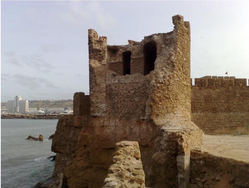
Figure 5.1a - Destruction de la tour nord du Château de mer portugais en 2010
