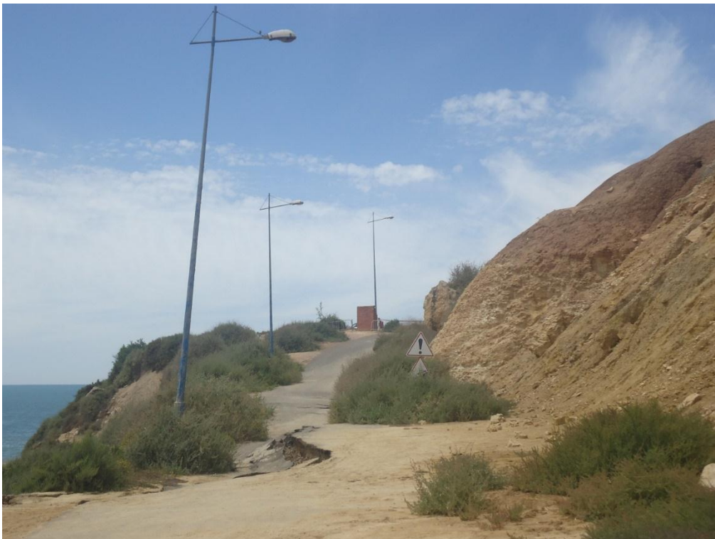
Figure 5.1b - Glissement de la route Ras Lafa au nord de la ville de Safi
