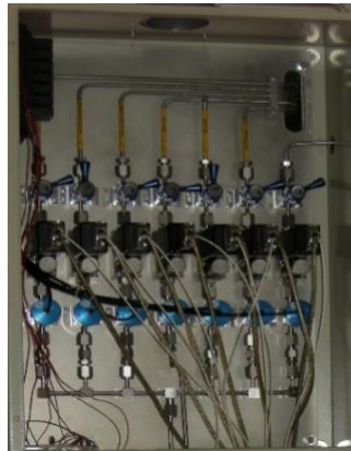
Figure 53 : Armoire de distribution des gaz
