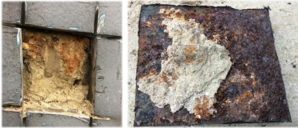
Figure III-15 Photographie d'une zone de prélèvement d'acier en partie aérienne des palplanches et état de surface des prélèvements côté remblai (corrosion superficielle uniforme sur la face en contact avec le remblai)
