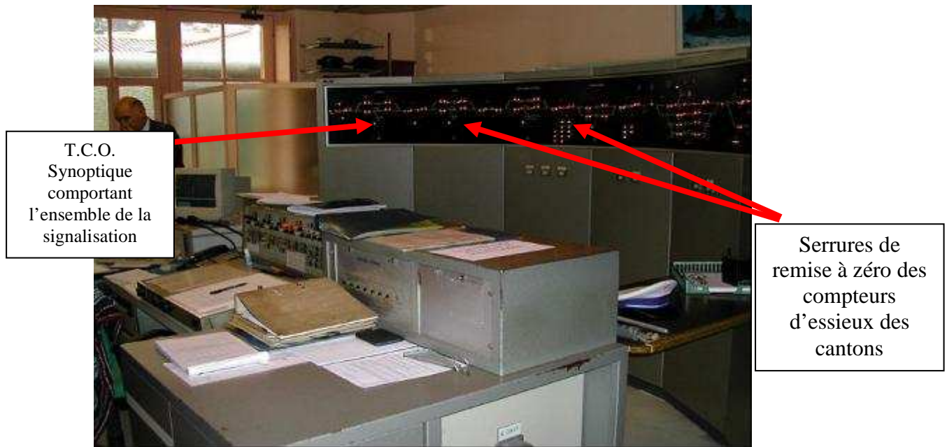
Figure Ann. 14 - Poste de travail de la gare de Breil – Le TCO.
