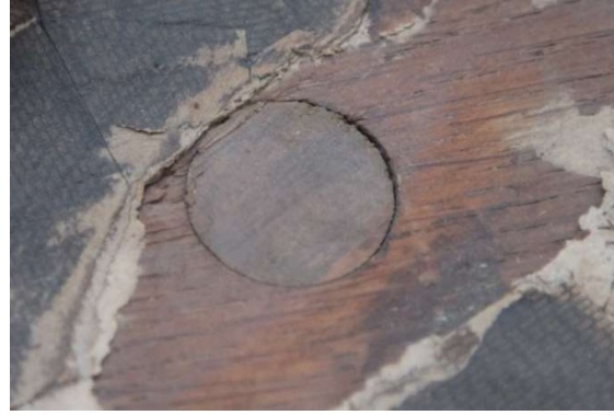
Figure 54 Trou rebouché, près de la porte Notre-Dame
