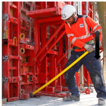
FIGURE 4.3: Fermeture de la banche à la barre à mine – Le compagnon applique une force verticale sur la barre pour déplacer le panneau
