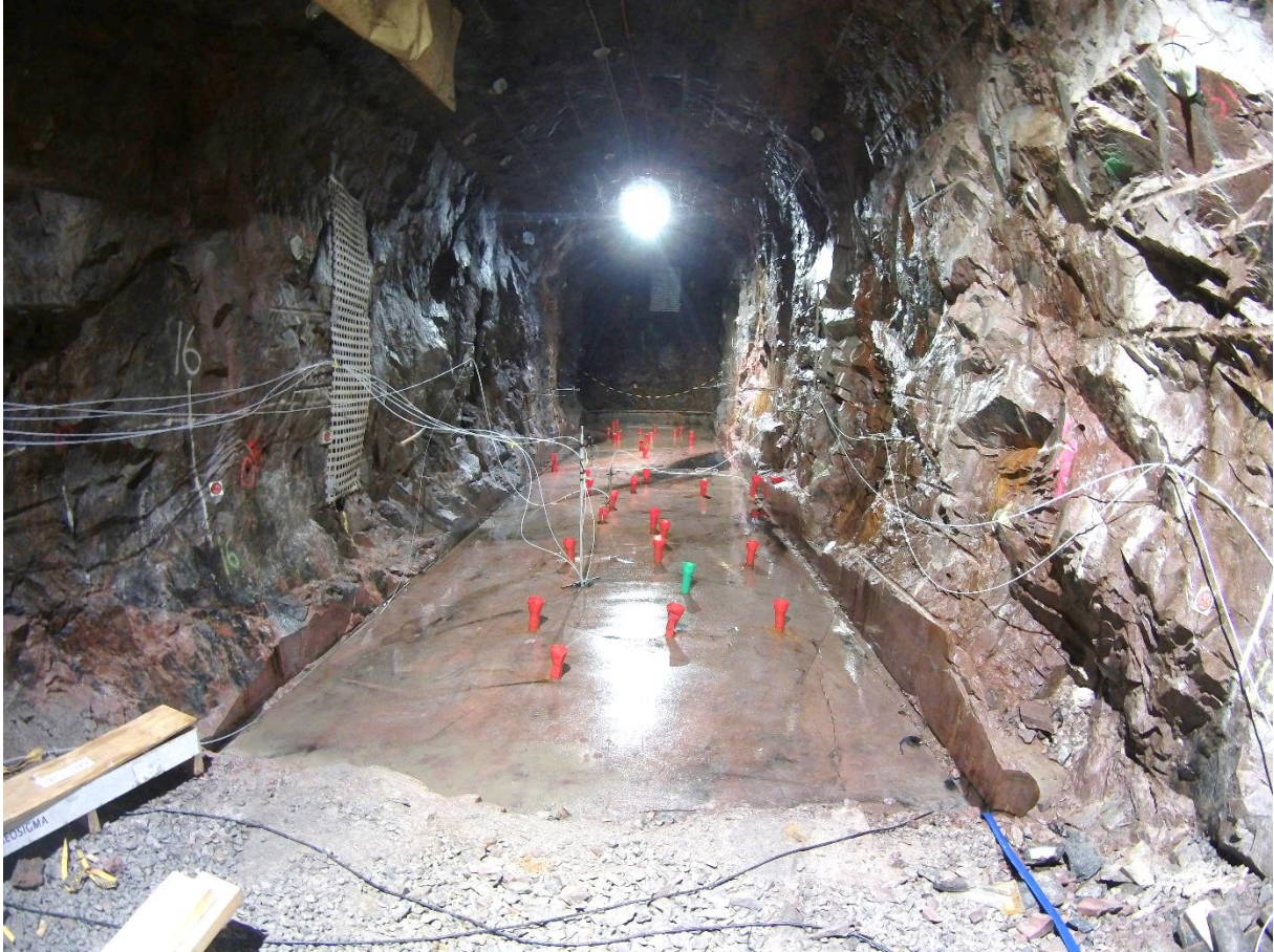
FIGURE 1-21: PHOTO PRISE DANS LE TUNNEL D'ÉTUDE (TAS04) APRÈS LE SCIAGE DE LA ZONE DE ROCHE INFLUENCÉE PAR LES FRACTURES INDUITES PAR CREUSEMENT DU TUNNEL. LES CÔNES ROUGES (ET VERT) SONT INSÉRÉS DANS LES 42 FORAGES (ENVIRON 2M DE PROFONDEUR) CREUSÉS POUR L'ÉTUDE DE LA ZDE. CES CÔNES PERMETTENT DE MAINTENIR L'EAU DANS LES FORAGES ET ÉVITER QU'ELLE NE SE RÉPANDE SUR LE PLANCHER DU TUNNEL.
