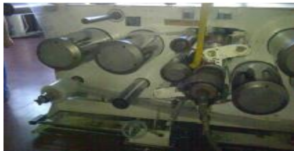
Figure IV-22 : Photo des enrouleurs à la sortie de l'extrudeuse
