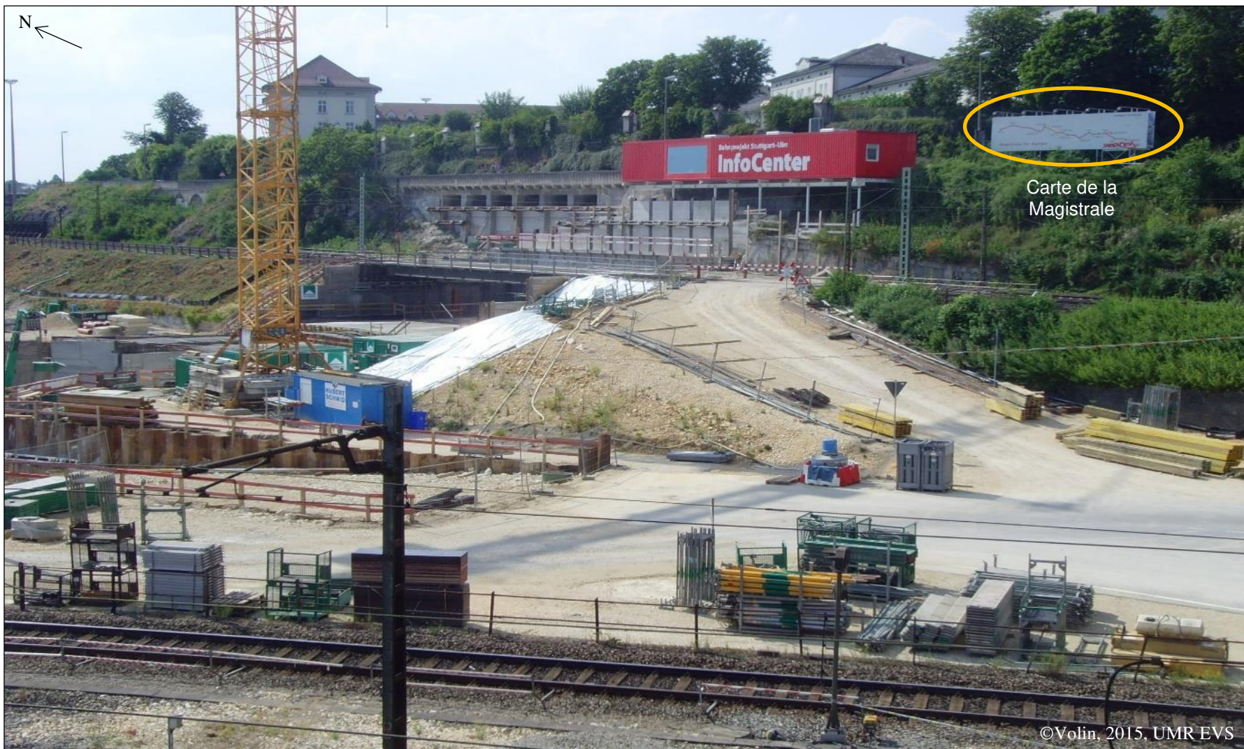
Photo 23 : Travaux d'aménagements ferroviaire, vue sur le centre d'informations du projet ferroviaire Stuttgart-Ulm (BPSU)
