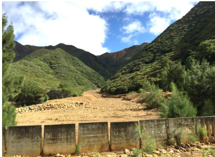
Figure 6 : Vue d'un aménagement (peigne) visant à réduire l'apport de sédiments grossiers sur le bassin versant de Thio (Source : O. Evrard)
