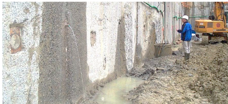
Figure I-17 Drainage à l'arrière de la paroi sur le chantier du Canal du Midi
