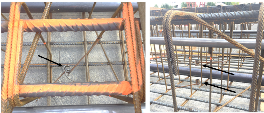
Figure II-112 Les barres de fixation alignées pour que le capteur soit installé horizontalement
