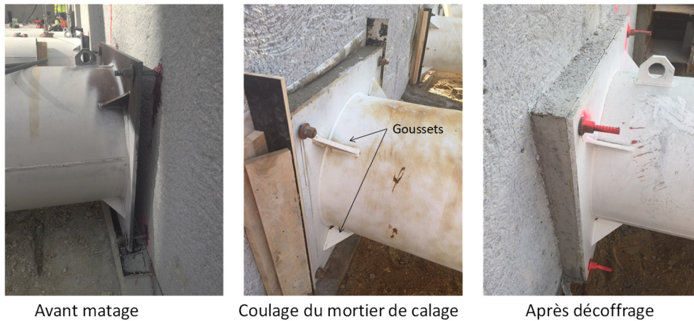
Figure II-24 : Matage – technologie d’assemblage de la platine du buton contre la paroi moulée
