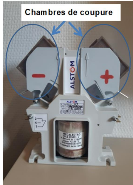
Figure 3.23 : photographie du contacteur présentant deux chambres de coupure (« déions »).
