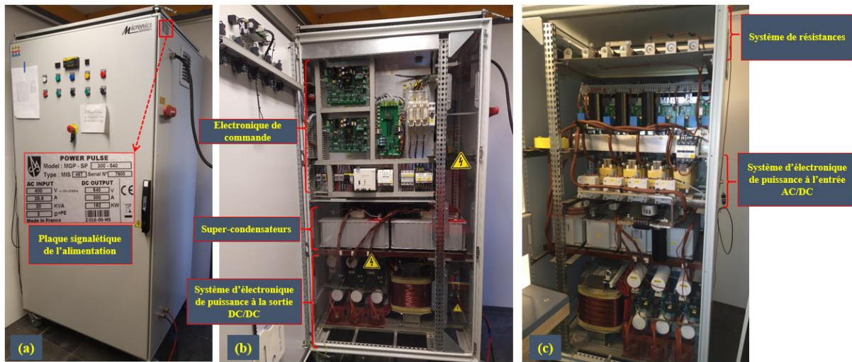
Figure 1.2 : photographies de l'alimentation à impulsion, (a) : vue de face, (b) et (c) : vue de l'intérieur côté face et opposé, la durée maximale l'impulsion est de 10 s, U_{max}= 540 VDC, I_{max}= 300 A, P_{max}= 162 kW.
