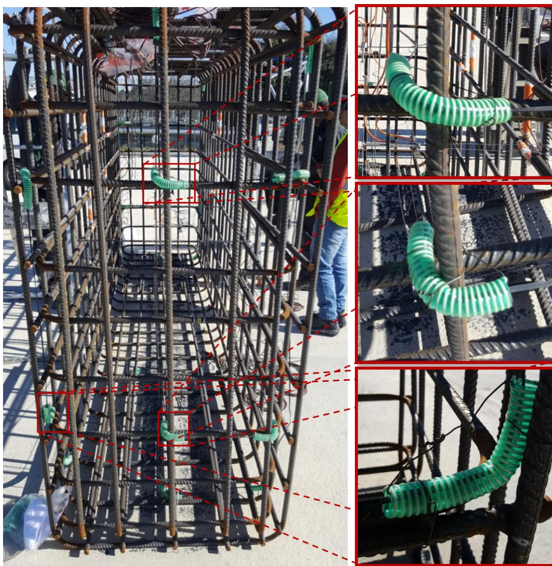
Figure IV-20 : Instrumentation du Bloc KB par câble Neubrex noyé dans le béton.
