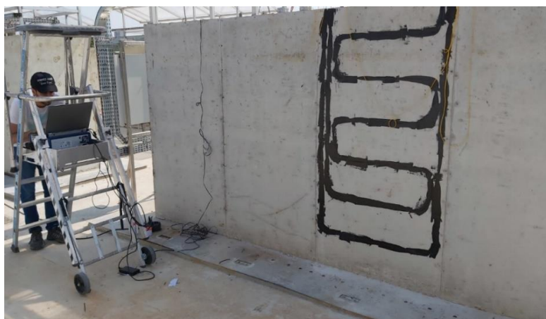
Figure IV-24 : Photo prise lors d'une interrogation du câble Neubrex en surface du Bloc KB .
