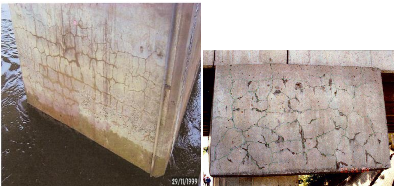
Figure I-47 : Manifestations de la RSI (réseau de fissures) [110].
