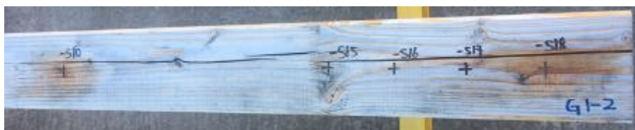
Figure III-8 : Fissures discontinuées visible en surface (exemple de la poutre CND DG1-2)
