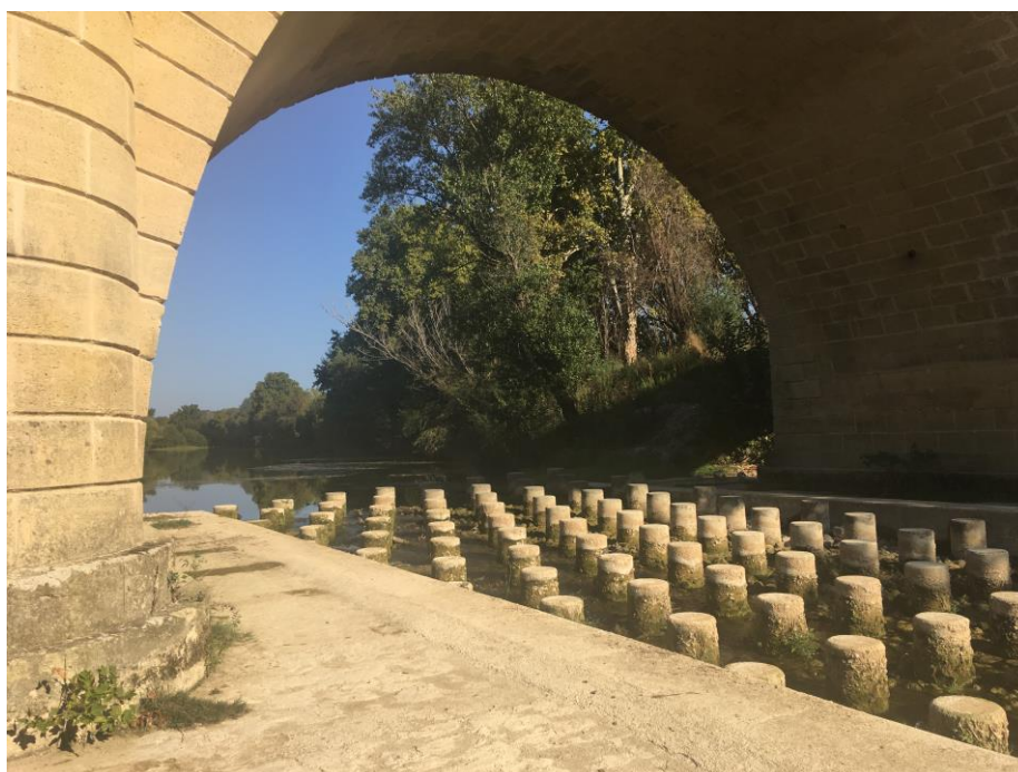
Passe-à-poissons observée à Gallargues-le-Montueux (Gard)
