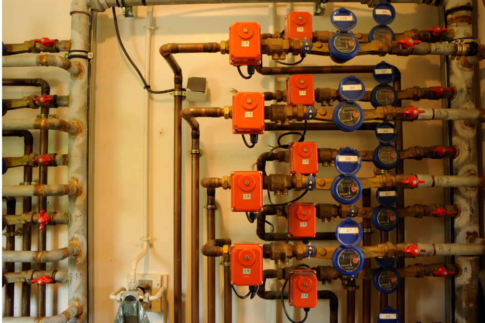
Photo 70 : Compteurs d'eau et d'électricité, local du gestionnaire, aire d'Annecy, Alexandra Frankewitz, 2012.
