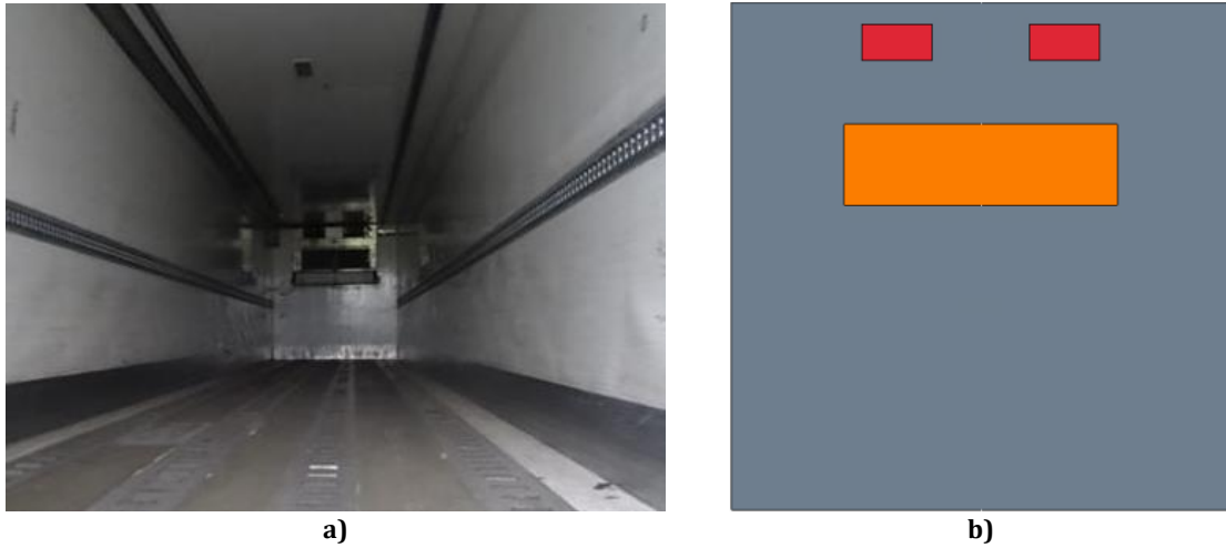
Figure 2.29 : Face avant du groupe frigorifique, a) photographie, b) configuration modélisée (rouge : bouches de soufflage, orange : reprise d'air).
