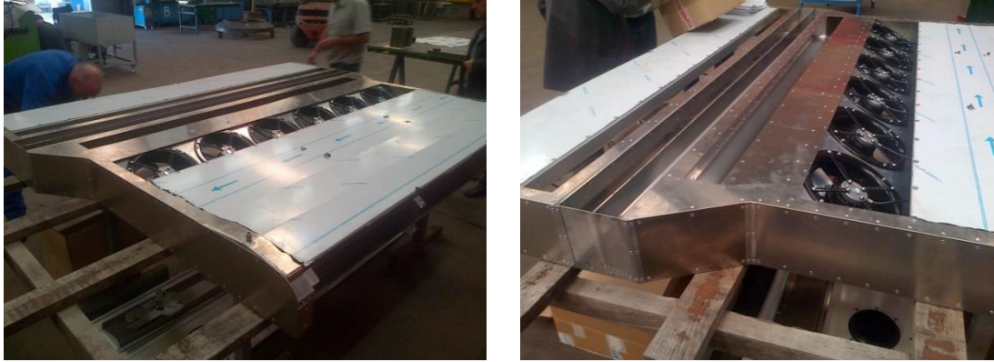
Figure 4.4 : Photographies du dispositif de rideau d'air, vue de dessous (les trois trappes d'accès sont ouvertes).
