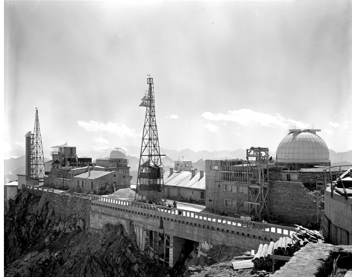
Figure 2.12 – L'Observatoire durant les travaux du bâtiment interministériel, 9 septembre 1962 | © Régie du Pic du Midi
