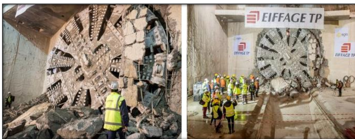
Figure 5-2 : Le tunnelier Nolwenn utilisé pour le creusement du tunnel du tramway T6
