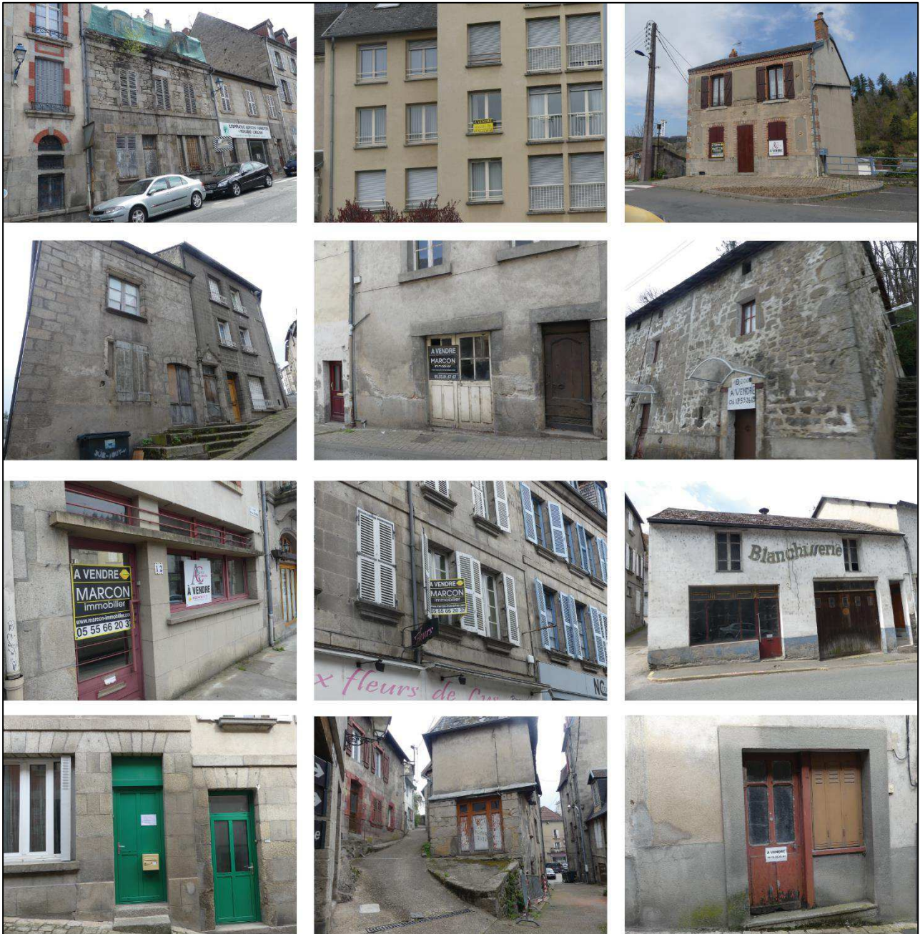
Figure 42 : une dégradation du bâti et une vacance locative prégnante à Aubusson (29% de vacance locative en 2016) (Cuenot, 2019)
