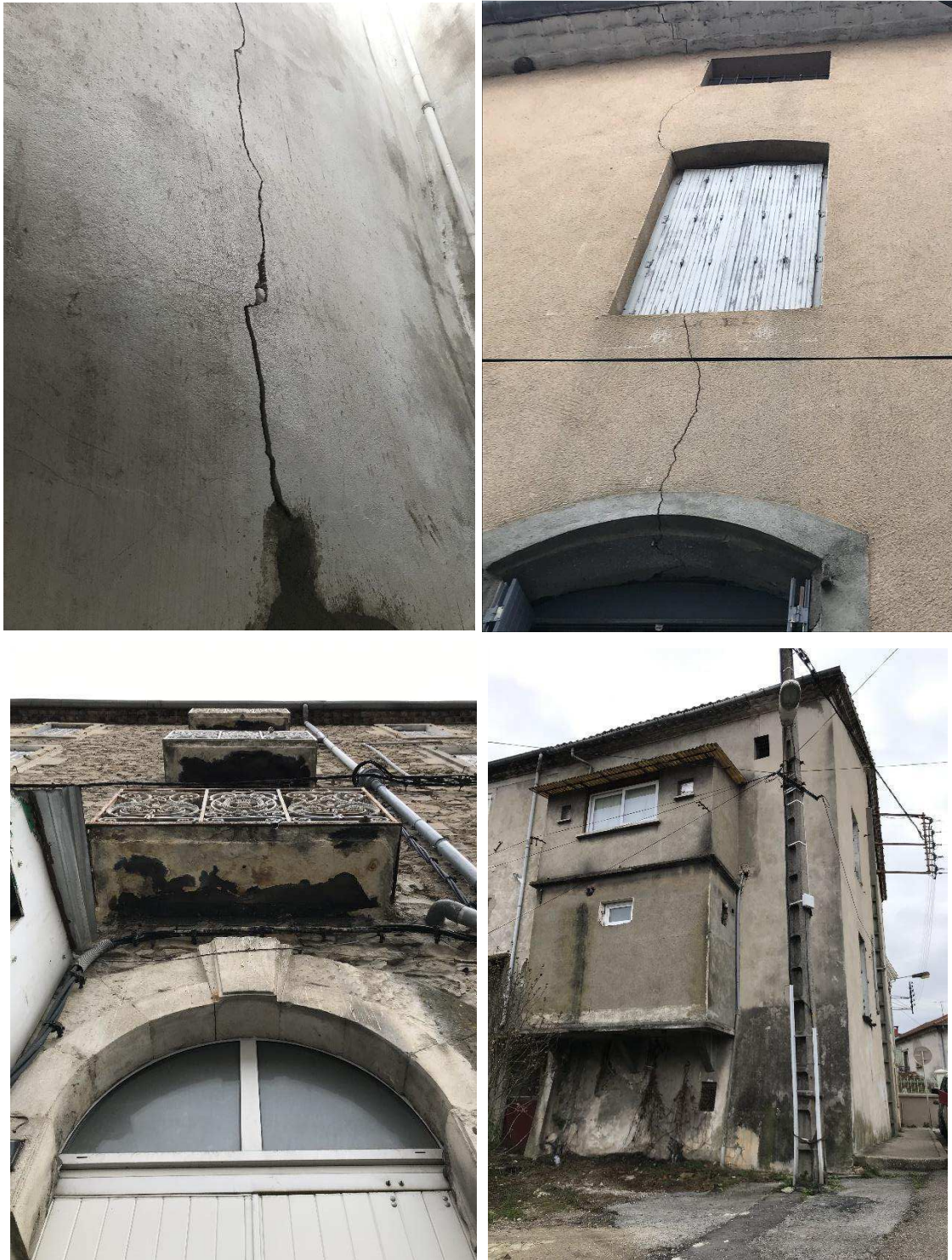
Figure 84 : d'autres sont très dégradés : ils peuvent mettre en danger les occupants et conduire à du mal-logement (Anduze et La Grand'Combe) (Cuenot, 2020)
