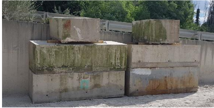
Figure 66 : Longrines (plateforme de recyclage Clamens – Villeparisis)
