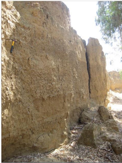
Photo 5. Portion de la paroi sur le point de s'effondrer et chaos de matériaux d'anciennes chutes. Vue sur la Medjerda à douar Ouled Ammar, 3.5 km en aval de Ghardimaou (Cl., personnel, 11/08/2008).
