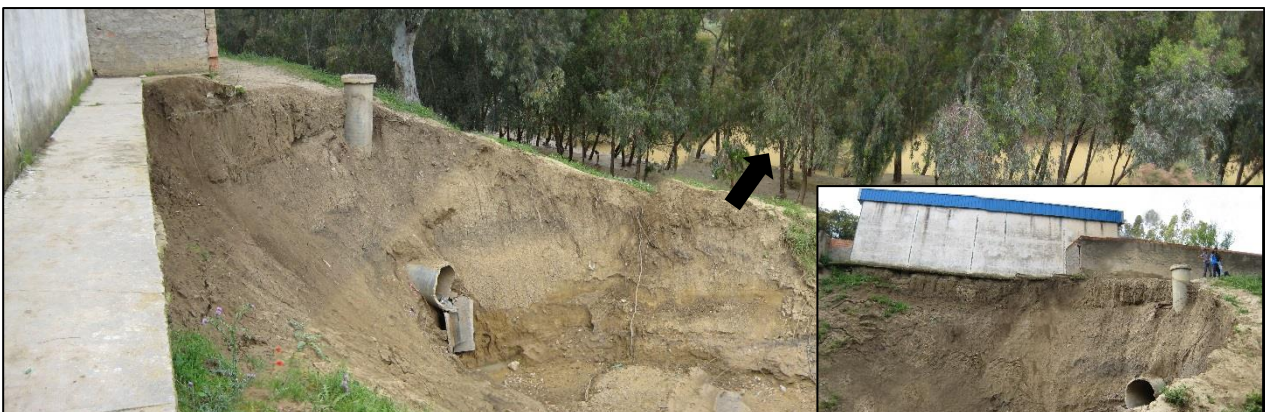
Photo 26. Constructions et canalisations des eaux pluviales au quartier d'Ezghaddiya, sérieusement atteintes par les eaux de crue de l'oued Medjerda en mai 2009 (Cl., personnel, 5/5/2009).
