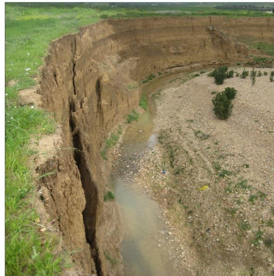
Photo 6. Paquet terreux affecté par une fente béante sur la berge droite de l'oued El-Melah, 500 m environ de sa confluence avec l'oued El-Khouitra à Chemtou (Cl., personnel, 31/03/2013).
