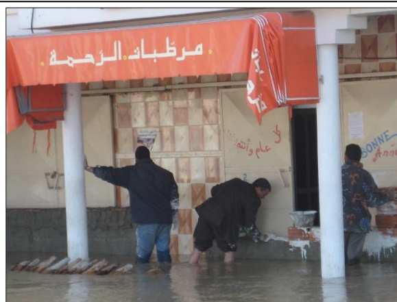
Photo 15. Construction de murets devant les boutiques pour parer à l'intrusion des eaux débordantes (Cl., personnel, 24/02/2012).
