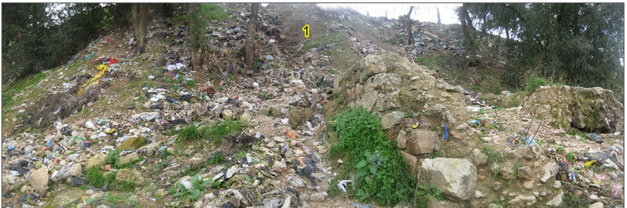
Photo 63. Le reste de la culée du pont jonché d'ordures ménagères (Cl., personnel, 12/01/2014).
