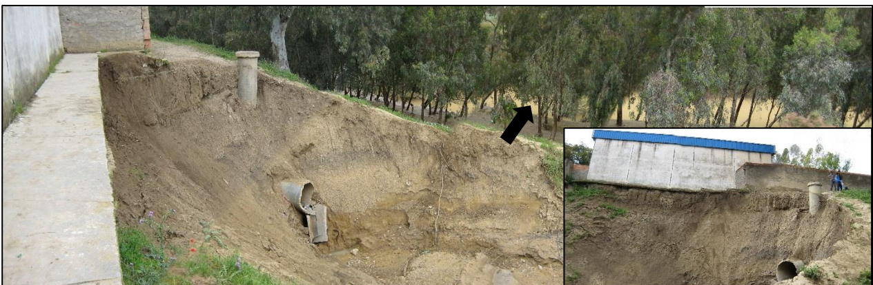
Photo 26. Constructions et canalisations des eaux pluviales au quartier d'Ezghaddiya, sérieusement atteintes par les eaux de crue de l'oued Medjerda en mai 2009 (Cl., personnel, 5/5/2009).
