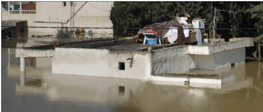
Photo 20. Une maison au quartier Fattouma Bourguiba (Bou-Selem) qui baigne dans l'eau. Sur le toit quelques biens mobiliers sauvés à temps! (Cl., personnel, 24/02/2012).
