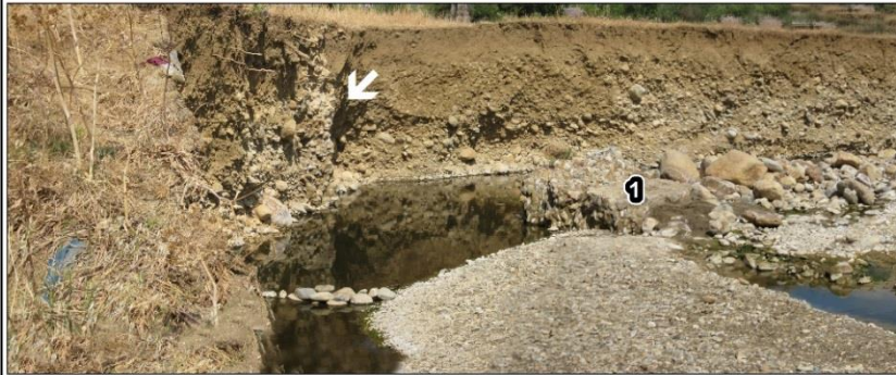
Photo 57. Le même endroit revu par nous-même en 2009. Il s'agit d'un mur antique en place de 3,70 m de hauteur, formé de moellons non équarris liés par un mortier beige. Par comparaison avec la photo de 2006, il ne subsiste plus qu'un seul fragment (1) du mur parmi les trois fragments (1, 2, 3) vus auparavant (Cl., personnel, 21/06/2009).
