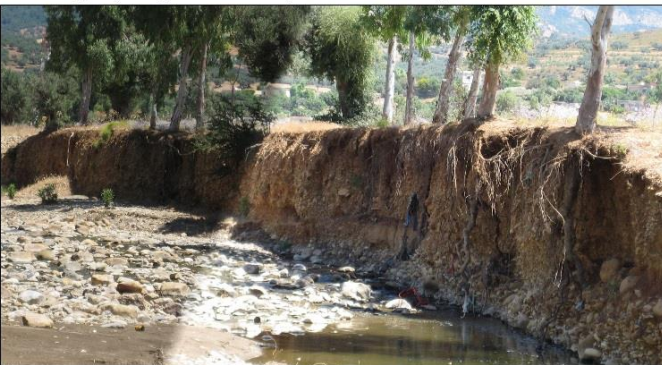
Photo 2. Déchaussement des plantations riveraines sous l'effet du retrait de la berge droite du cours aval d'El-Hammem à Werghich (Cl., personnel, 13/06/2009).
