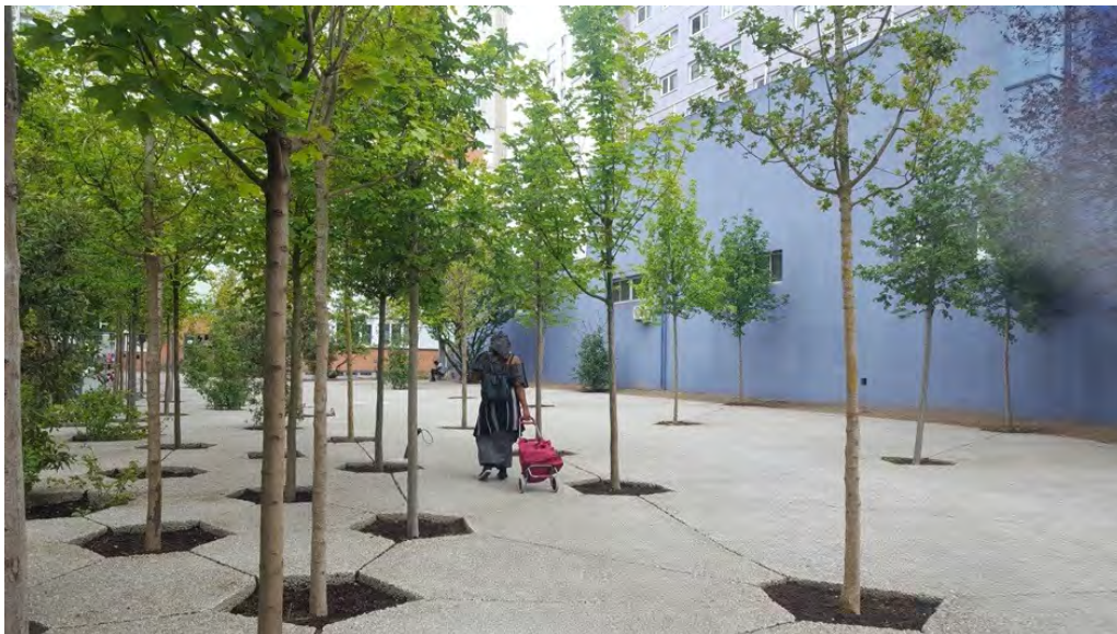
Figure 21 : Finalisation du revêtement urbain poreux sous forme de dalles non jointives. Source : photo prise par l'auteure le 10/07/2020
