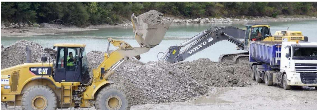
Fig 32. Curage du Buëch au niveau du piège à Graviers. (Source : Journal Le Dauphiné. Sept 2014)
