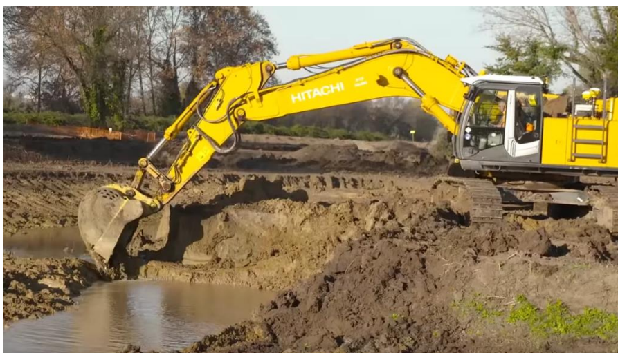
Fig 15. Opération de reméandrage de la rivière par la pelle mécanique (Source : EPTB Vistre)
