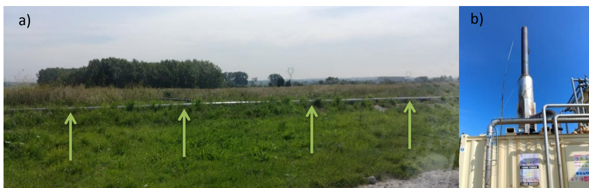
Figure II-3 : a) Conduit pour la récupération du biogaz, b) Torchère
