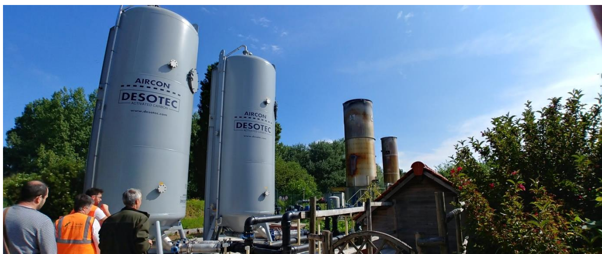
Figure II-4 : Cuves de charbon actif en série pour l'élimination du H_2S
