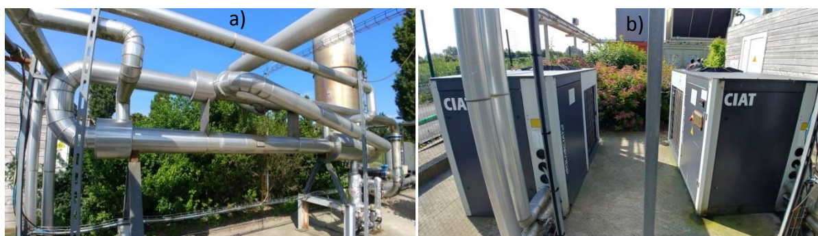
Figure II-5 : a) Système de séchage du biogaz, b) Système de refroidissement de l'eau glycolée
