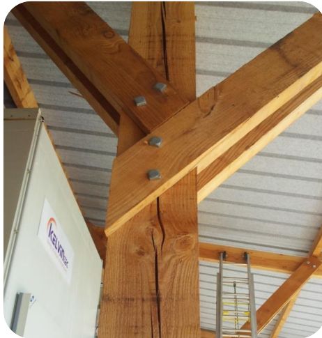
Figure V-14 : Fissuration d'un poteau au niveau d'un assemblage
