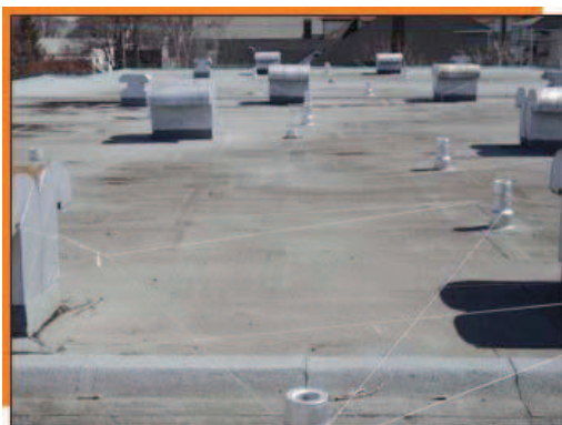
Figure 27 : Fils sur les toits de la ville de Rimouski (Québec)
