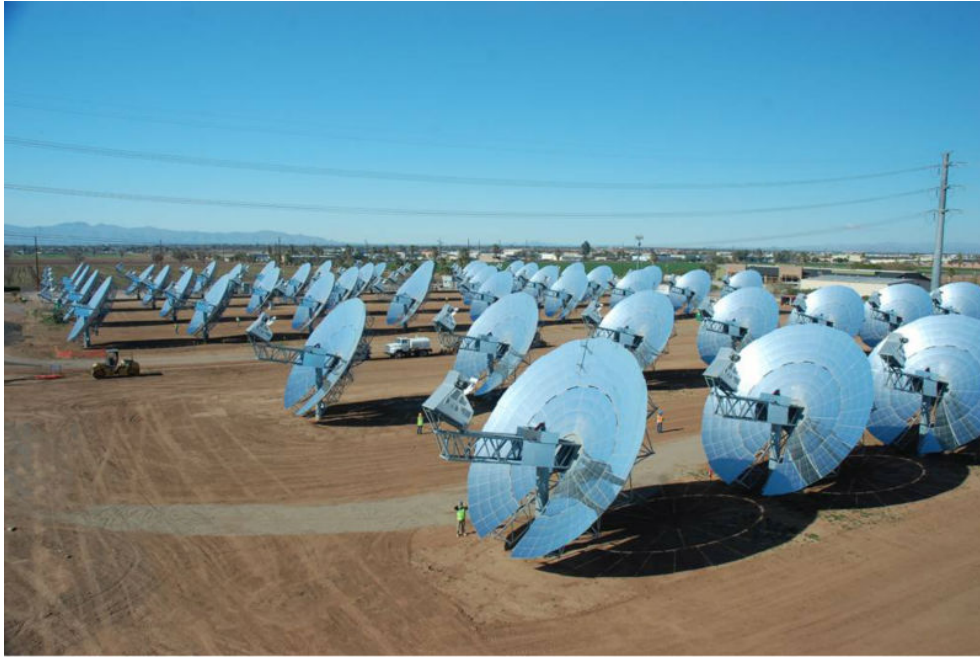
FIGURE 24 – Centrale solaire composée de concentrateur paraboliques couplés à des moteurs Stirling
