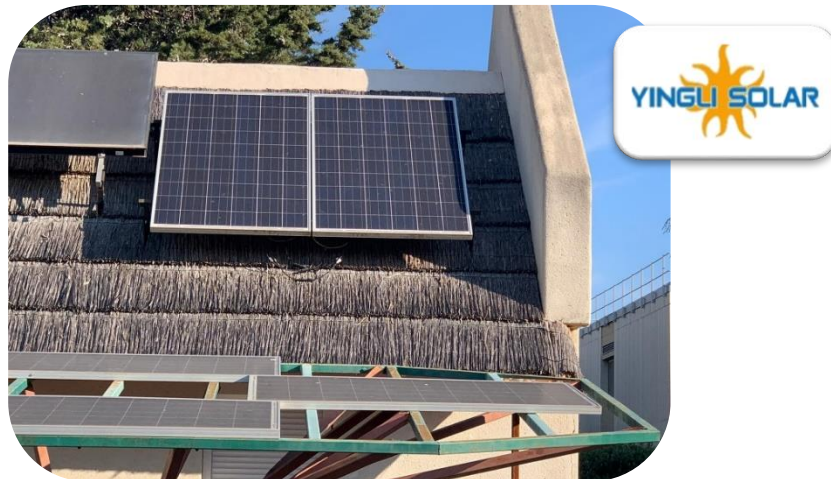
Figure 3-11. Deux panneaux solaires photovoltaïques installés sur le versant SUD de la toiture du bâtiment, d'inclinaison 45°
