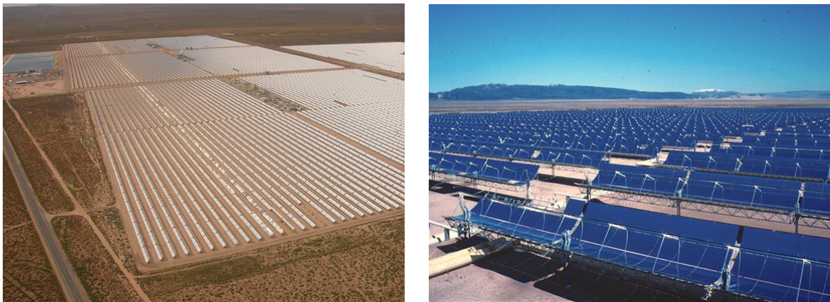
Figure 5 : Photographie aérienne et vue au sol de la centrale cylindro-parabolique SEGS (Solar Energy Generating Station) située en Californie aux États-Unis (12).
