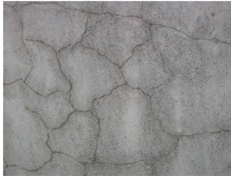
Figure 48 – Exemple d’un faiçençage surfacique du béton ( http://www.thethermographiclibrary.org/index.php?title=Fichier:Faiencage.jpg )
