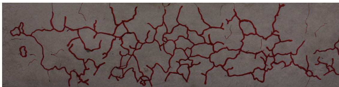
Figure 3.32 – Exemple d’un faïençage causé par un retrait de dessiccation durant plus de cinq années [Soleilhet, 2018]. La fissure locale apparaît de manière othogonale sur les bords. Les fissures visibles à l’oeil sont surlignées en rouge.
