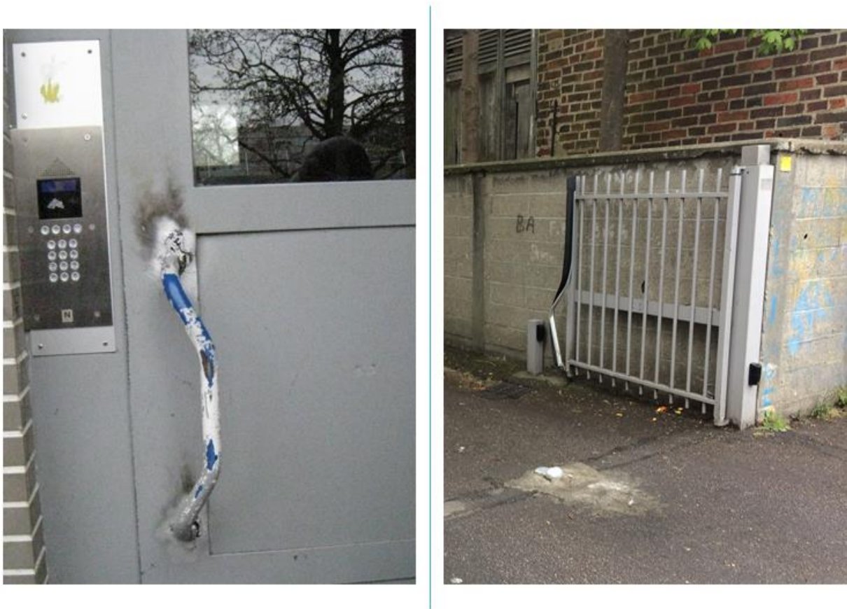
Figure 38. Des portes et des contrôles d'accès vandalisés. Source : à gauche, A. Mille, avril 2017 (bailleur enquêté, Yvelines) ; à droite, document interne du bailleur, avril 2016 (Projet de Gestion de Site).
