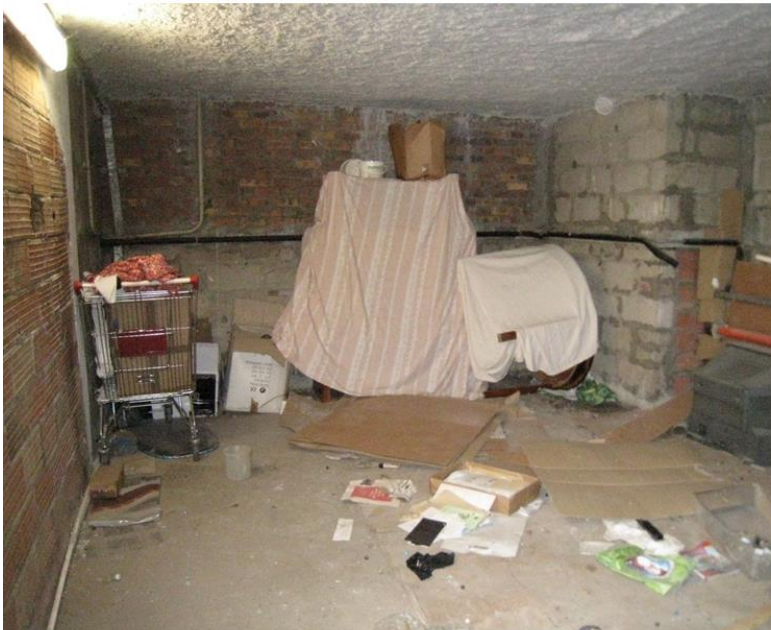
Figure 32. Dégradations dans un local commun régulièrement squatté. Source : document interne du bailleur (Projet de Gestion de Site).
