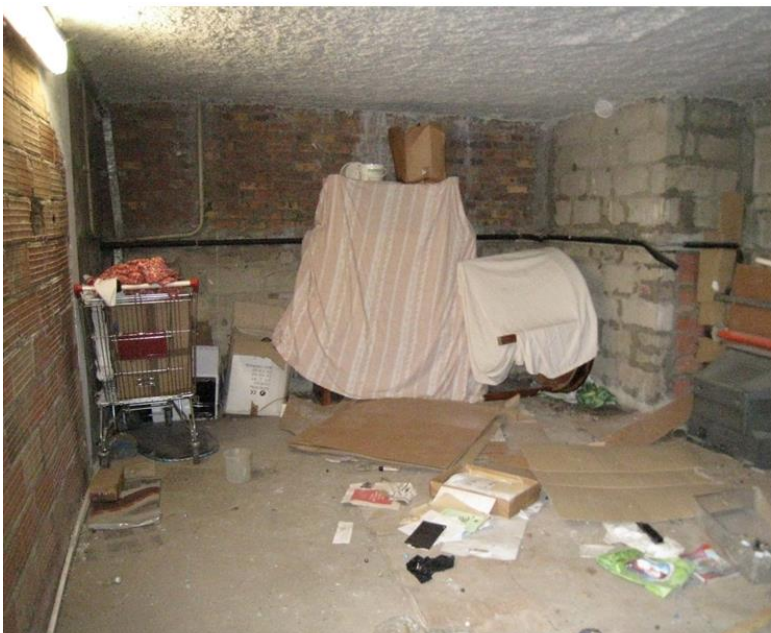
Figure 32. Dégradations dans un local commun régulièrement squatté. Source : document interne du bailleur (Projet de Gestion de Site).
