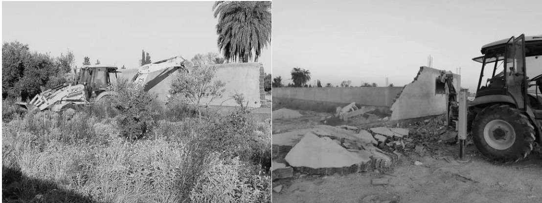
Figure 48 : démolition des constructions illicites dans l'espace agricole de Sahline (Source : commune de Sahline)
