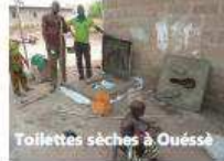
Toilettes sèches à Ouesso
