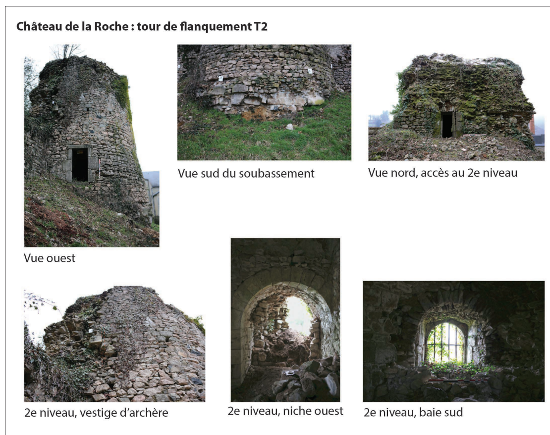
La tour de flanquement sud (V. Chevassu, 2017, planche publiée in Nouvel et al. 2017).
